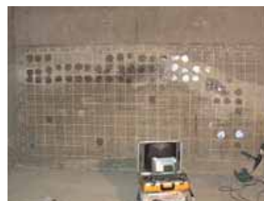
写真 3 超音波厚さ測定後
